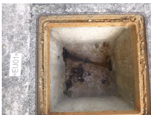
Figure 6 : Regard EU1 en sortie de bâtiment (sec)
