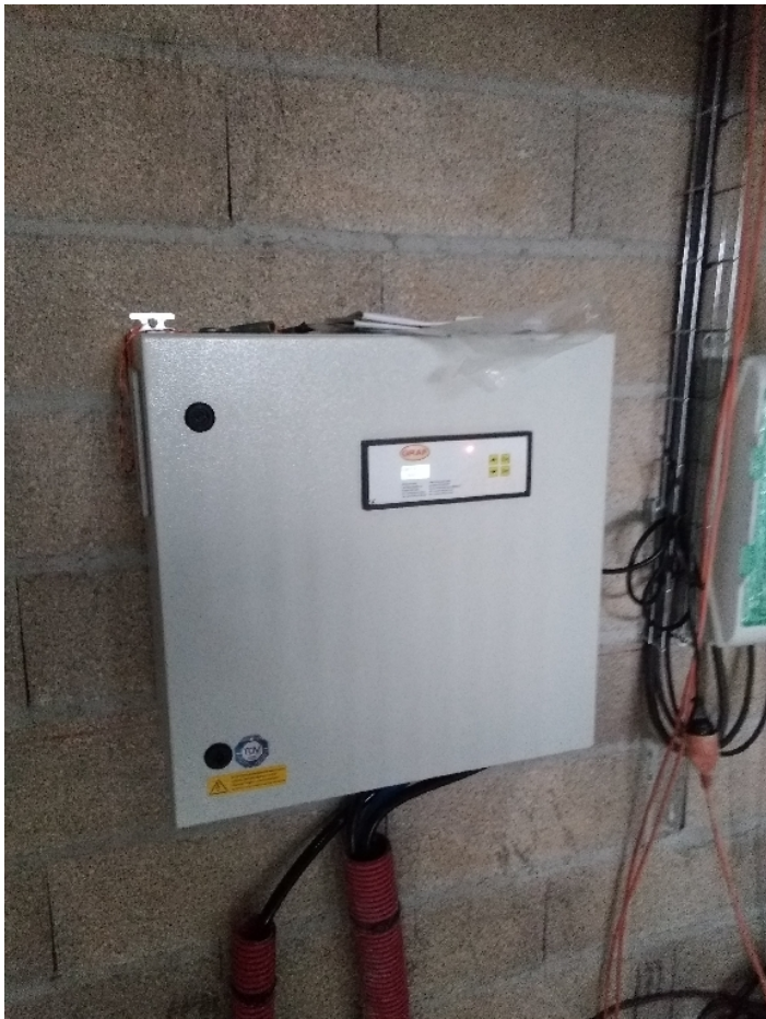
Photo armoire de commande fermée
