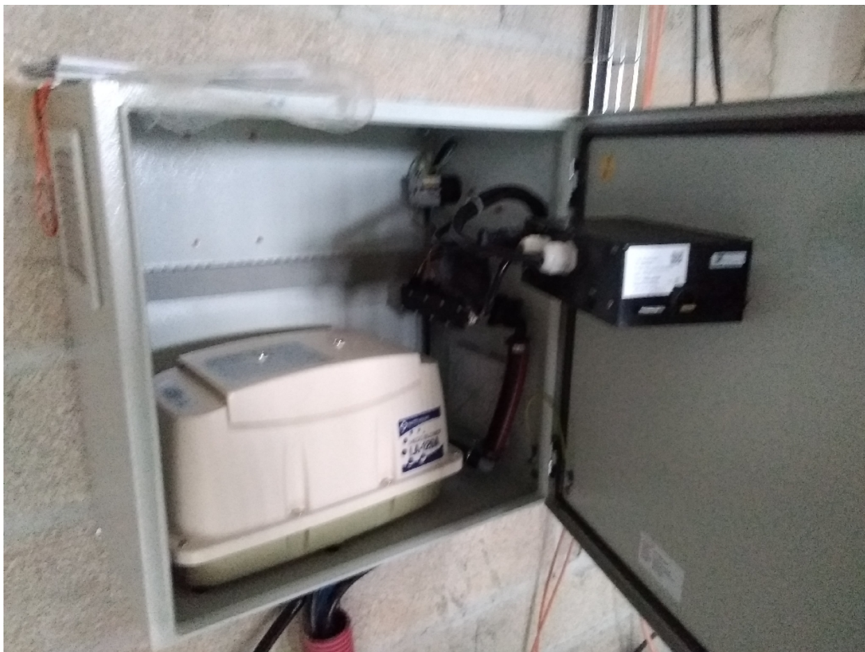
Photo armoire de commande ouverte
